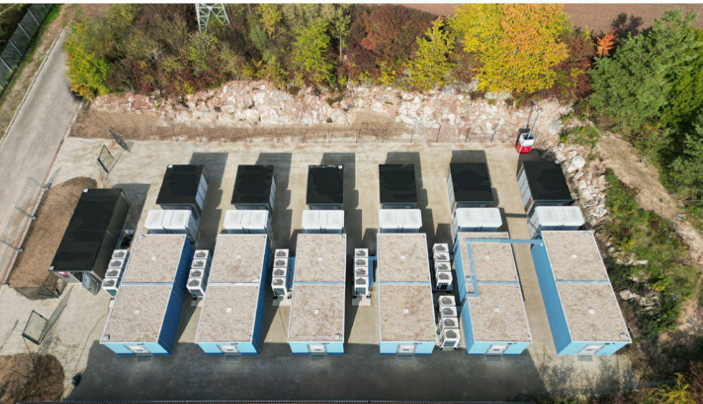
VRF-Außeneinheiten von Panasonic zur Klimatisierung der Batteriespeicheranlage
